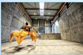
Her er givet fra den nyopførte silo med den nye kran og siloen, som kan føre afaldet over i den eksisterende silo.
