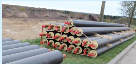
Metallerede fjernvarmerør klar til brug.
