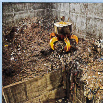
Affaldet brændes og leveres til fjernvarme. Affaldskranen er i sving dagligt rundt.
